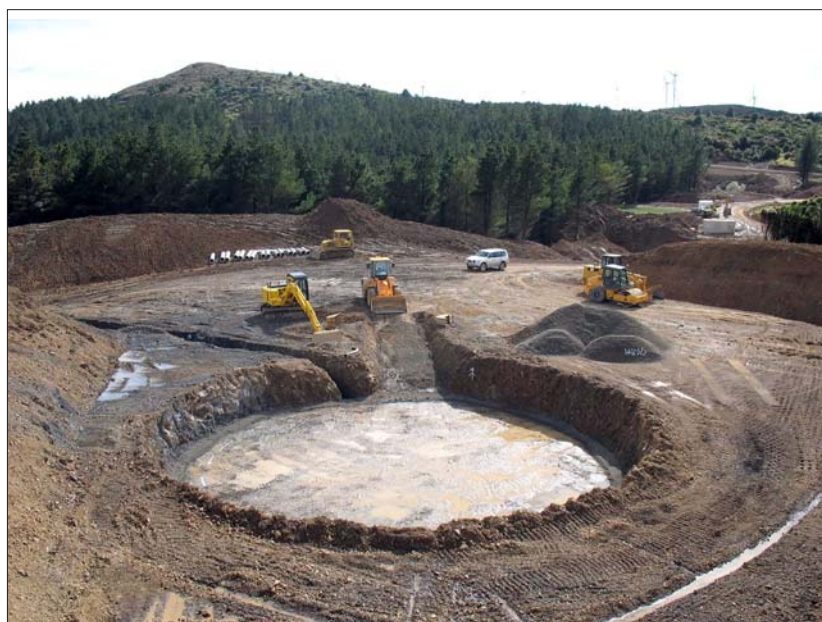
Fot. 2. Przygotowanie fundamentów pod turbinę wiatrową (3MW) o wysokości wieży 80 m i średnicy ramion 90 m. Włochy.
